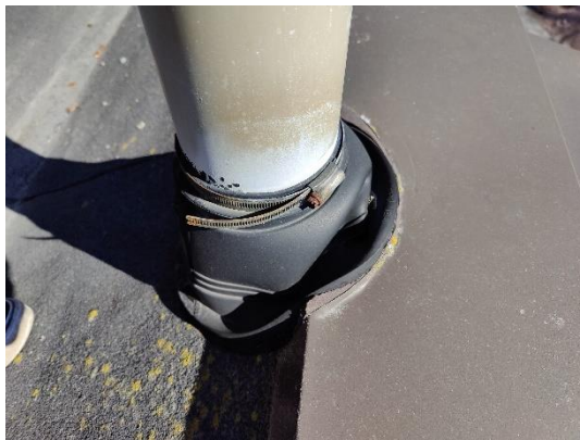
Viemärin tuuletusputki liian lähellä räystästä. Rajauksessa saattaa olla epätiiveyttä.
