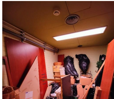
Varastosta puuttui IV-päätelaitteita ja tuloilmaventtiilistä puhaltti todella kovaa.
