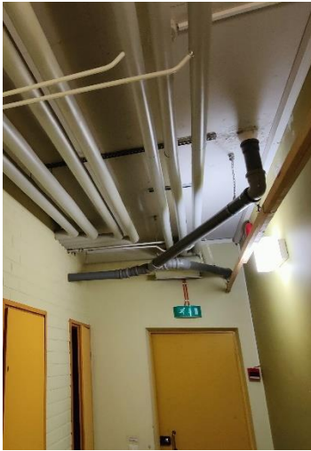
Kellarin katossa olevia viemäreitä on kannakoitu reikäkiskolla. Viemäreiden kannakoinnissa on suositeltavaa käyttää putkipitimiä.
