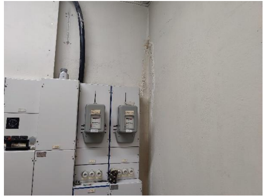
Kellarin sähköpääkeskuksen maanvastaisella seinällä kosteuspoikkeamaa.
