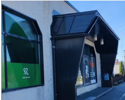
Piha-alueen valaistus vähäinen. Ulkovalaisimet ovat käyttöiän päässä.
