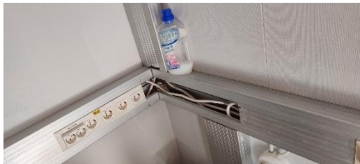
Johtokanavien suojakourujen peitekansia puuttuu. (Mehiläinen)
