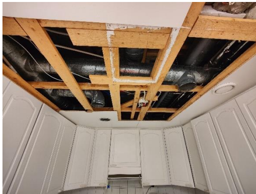
Kellarikerroksen keittiöstä puuttui IV-päätelaitteita.
