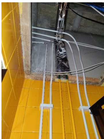
Käyttövesiputket on tehty komposiittiputkista.
