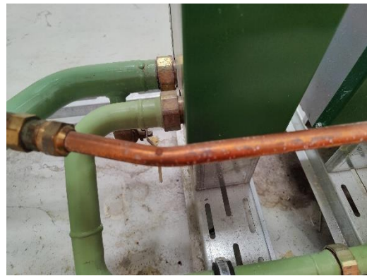
Täyttöventtiiliin kupariputkessa on mahdollista pistesyöpympää.
