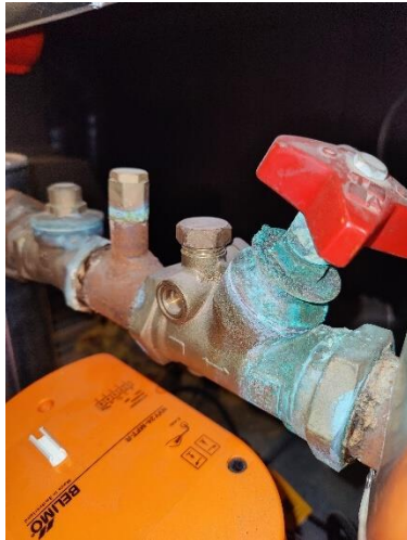
Ilmanvaihtokoneen lämmityspatterin säätöryhmän linjasäätöventiili.
