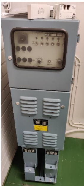
PK-tilassa vanha loistetekokomp. Ei ole käytössä. Suositellaan purettavan ja toimitettavan kierrätykseen.
