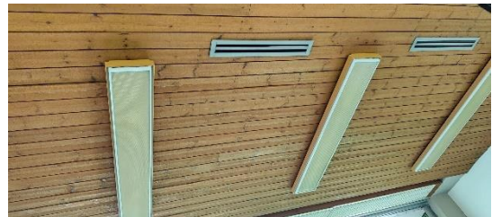
Mehiläisen tila, metallirunkoisia loisteputkivalaisimia.
