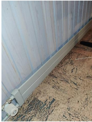
Alkuperäinen lämmityspatteri ja patteriventtiili.
