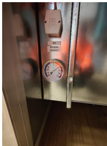
IV-koneiden tuloilman asetusarvo on korkea.
