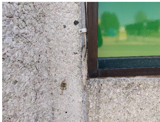
Ikkunoiden ja julkisivujen väliset saumamassat huonokuntoiset.
