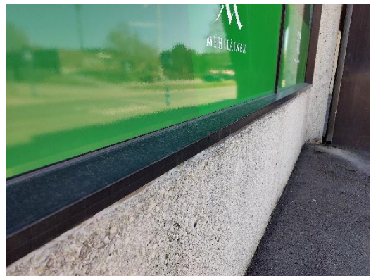
Ikkunoiden karmien ulottuma julkisivupinnasta lähes olematon, kallistuspuutteita.
