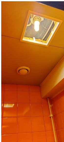
Kellarin WC-tilojen valaistus uusittava.
