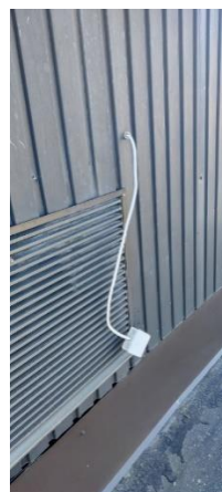
Katolla on vanhoja kaapelointeja irrallaan.
