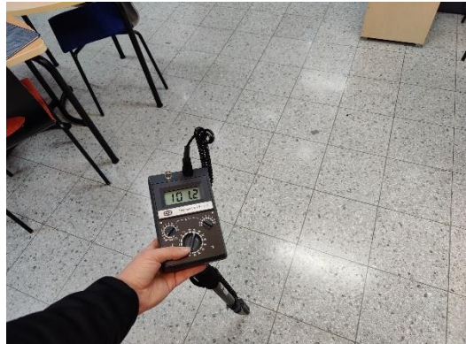
Kirjaston lattiapinnoilla koholla olevaa kosteutta.
