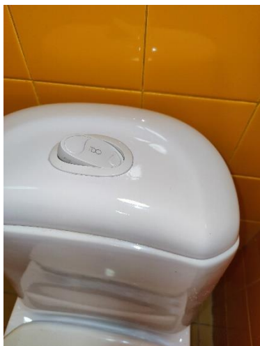
Kellarikerroksessa uusittu WC-istuin, jossa on kaksitoiminen huuhtelu. Huuhtelunappi on rikki.
