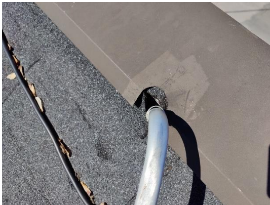
Sähköjohtojen kattoläpiviennit epätiivitä.
