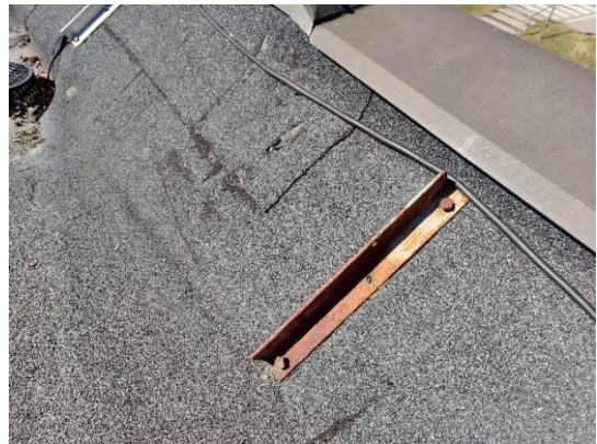
Vanhan kyltin kiinnitykset lävistäneet huopakaton. Asennus ollut epätiivis.
