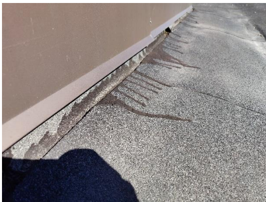
Puutteellisiä kermiasennuksia. Tiivistävä ylösnostokermi puuttuu. Kyseessä todennäköisesti vanha paikkauskohta.
