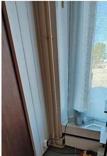
Lämmityspatterin kytkentä- ja jakojohdoja kierre- ja hitsausliitoksin.
