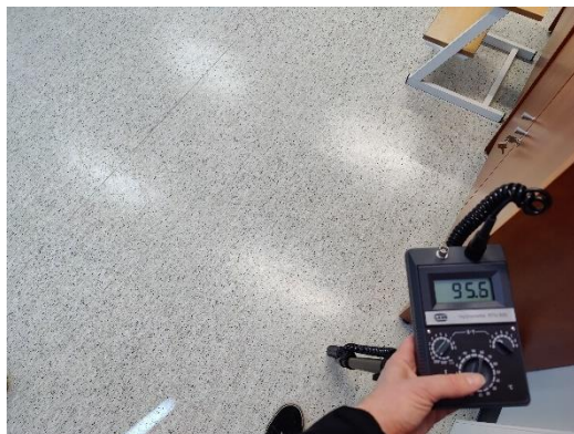
Kirjaston lattiapinnoilla koholla olevaa kosteutta. Tilassa muovimattoa.
