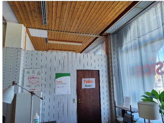
Kattokaivolta aiheutunut kattovuoto.
