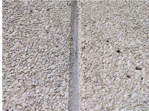
Elementtisaumat paikoin huonokuntoiset.
