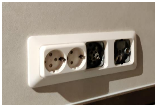
TV-antennipisteestä puuttuu peitelevyt (kellari saunatilat)
