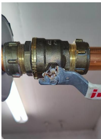
Käyttöveden sulkuventtiilissä korroosiota lämmönjakohuoneessa.
