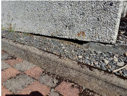
Kirjaston puoleisessa päädyssä seinäelementin alta valui hiekkaa. Seinän ja perustuksen rakenne varmistettava.
