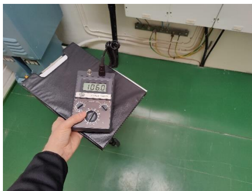
Sähköpääkeskuksen lattiapinnalla koholla olevaa kosteutta.
