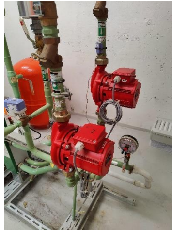
Ilmanvaihdon lämmityksen kiertoovesipumput.
