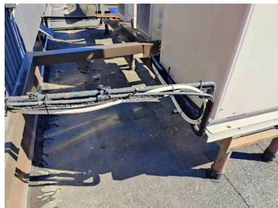
Jäähdytysputkien eristeet on haurastuneet ja irronnet lähes kokonaan.
