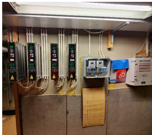
Ilmanvaihdon puhaltimien taajuusmuuttajat, ohjaukset ja hälytyskeskus.
