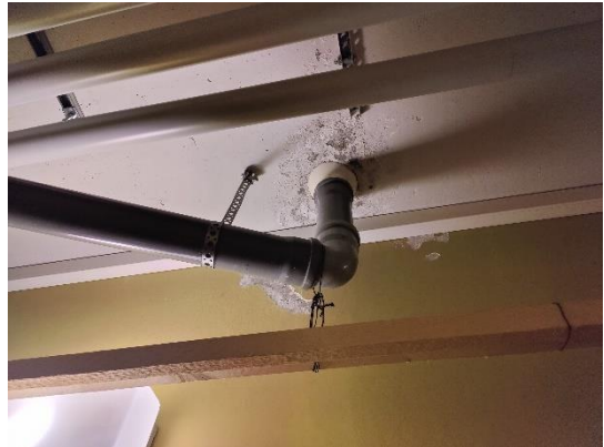
Kellarin katossa vanhoja kosteusjälkiä. Tarkastuksella pinnat olivat kuivia.
