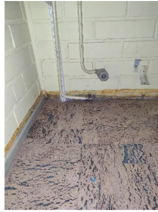
Kellarikerroksesta on poistettu lämmityspatteri. Patteriventtiilit on syytä tulpata.
