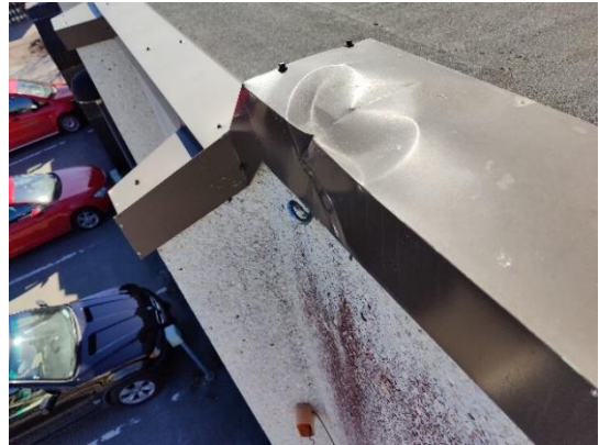
Räystääpelleissä vaurioita. Vaurioista aiheutunut vesivuotoja julkisivupinnalle.
