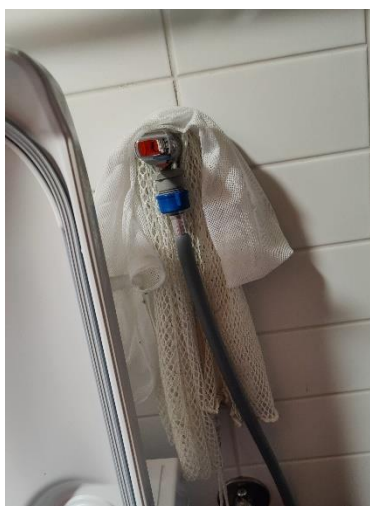
Pesukoneventtiilistä puuttuu imusuoja.
