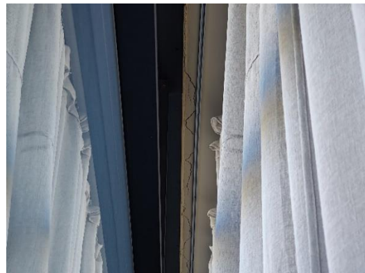
Fysioksen tilan ikkuna-aukon ylityspalkissa halkeama. Halkeama todennäköisesti vanha, mutta suositellaan halkeamaseurantaa.
