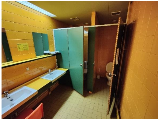
Kellarin wc-tilan lattialaatat kopoa. Pintamateriaalit ikääntyneet.
