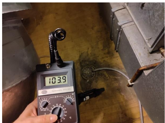
IV-konehuoneen lattialla koholla olevaa kosteutta lattiakaivon ympäriltä.
