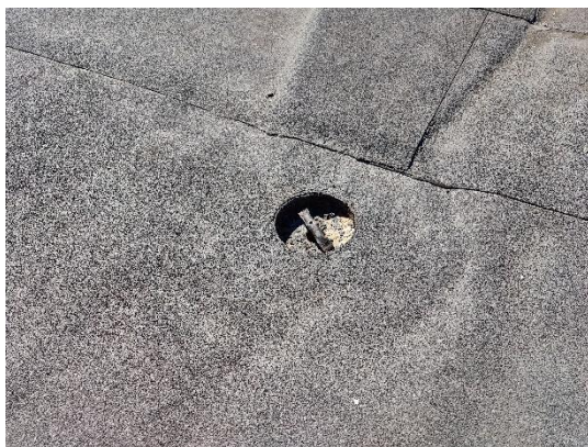
Kattokaivolta puuttui sihti.
