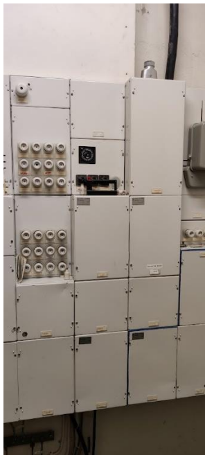
Pääkeskus alkuperäinen, pääkeskustila oli siisti.
