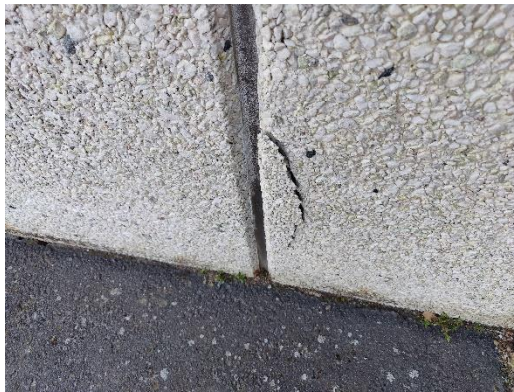
Yksittäinen halkeama elementin reuna-alueella.
