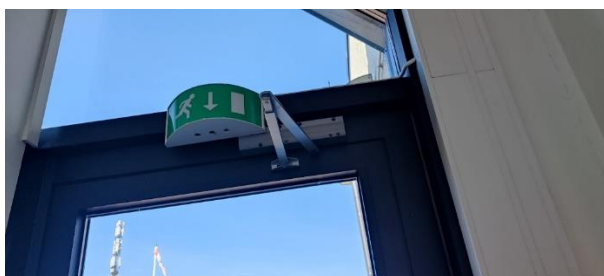
Poistumistievalaisimia, joista osa on uusittu.
