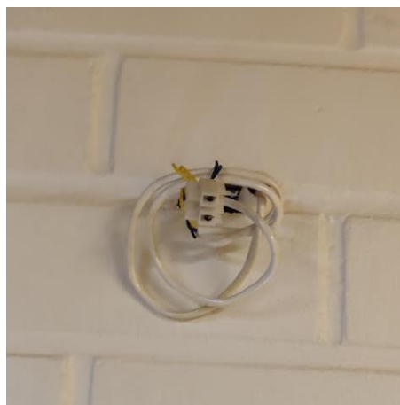
Kellarissa sähköjohto avoimena. Päättävä kojerasiaan.
