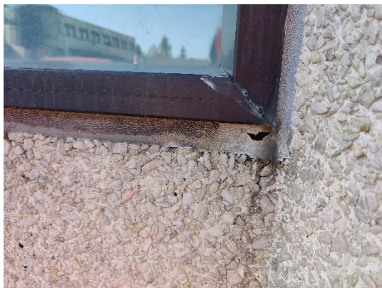
Ikkunoiden ja julkisivujen väliset saumamassat huonokuntoiset.
