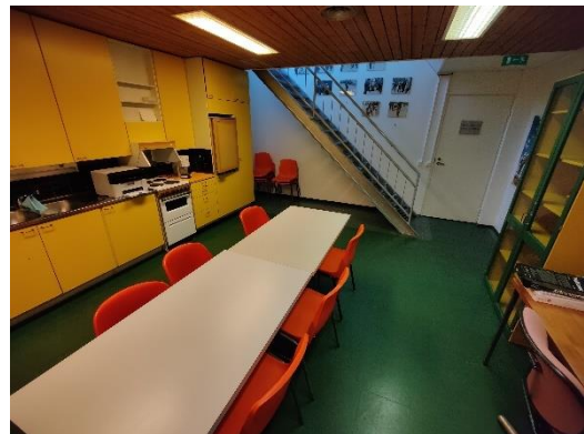
Kellarin kokoustilan/keittiön pintamateriaalit ikääntyneet.
