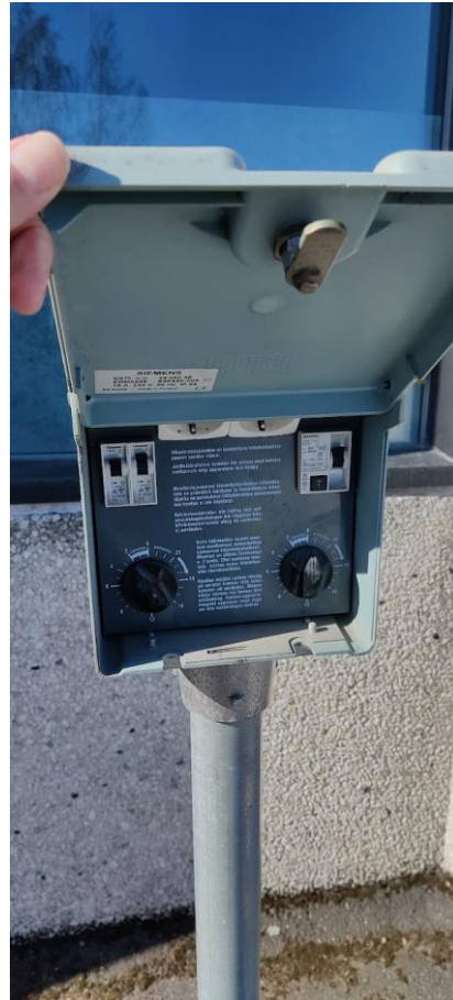
Autolämmityspistorasiat on kohtalaisessa kunnossa ja vikavirtasuojattuja.
