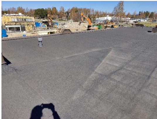
Kattokaivolta aiheutunut kattovuoto.
