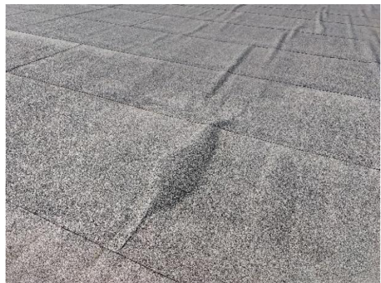
Höyrykuplia katteessa, sekä repeämää.
