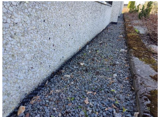
Patolevyissä ei ole käytetty yläreunalistaa. Sade- ja sulamisvesillä on mahdollisuus päästä patolevyn ja seinän väliin.
