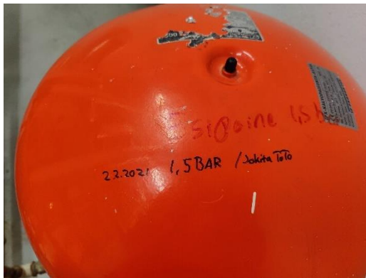
Paisunta-astian esipaine on tarkastettu viimeksi vuonna 2021. Paisunta-astian esipaine ja kunto pitää tarkastaa ja paisunta-astia tarvittaessa uusia.
