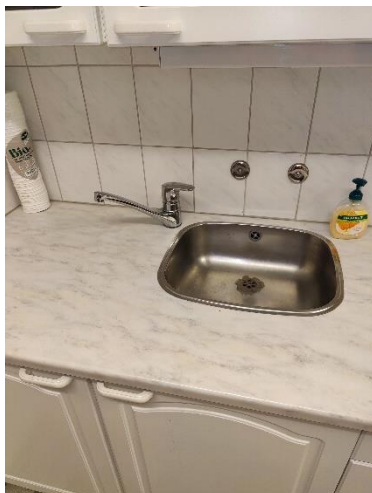
Kellarikerroksen keittiössä keittiöhanan juoksuputki on rajoittamatta.
