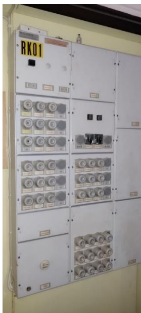
Kellarin saunaosaston vanha tulppasulakkeilla varustettu ryhmäkeskus.
