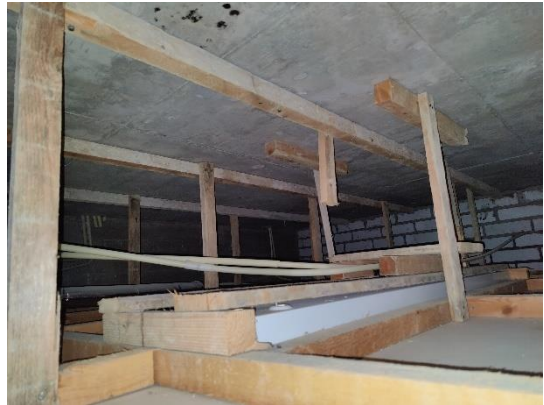
Kellarin osalta alaslasketuissa katoissa saattaa löytyä tiivistämättömiä läpivientejä.
