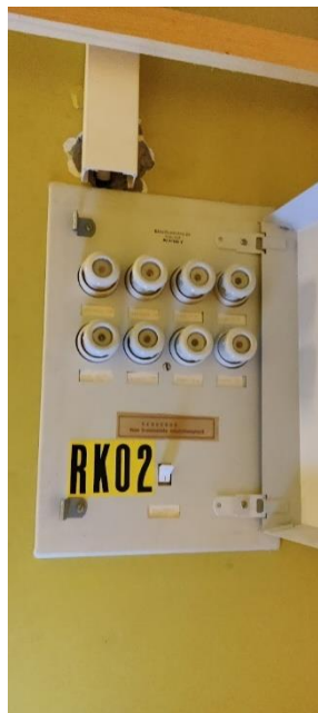
Kellaritiloissa vanha tulppasulakkeilla varustettu ryhmäkeskus.
