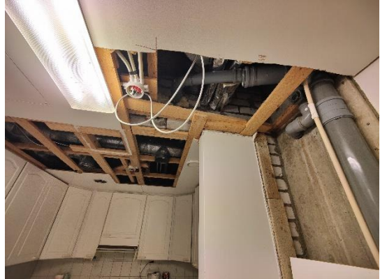
Osakkaiden tekemiä muutostöitä, saattaa löytyä tiivistämättömiä läpivientejä/väärinasennuksia.
