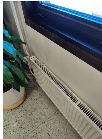
Kirjaston puolella on uudempia lämmityspattereita.
