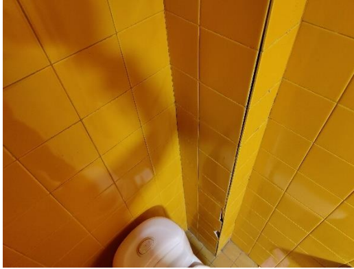
Halkeamaa wc-tilan seinäpinnalla.
