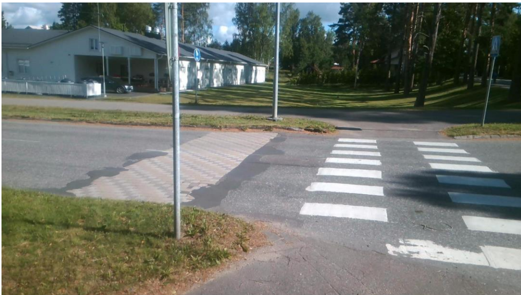
Kirkon edustan korotettu liittymäalue on huonokuntoinen ja hidastusvaikutusta ei ole.
